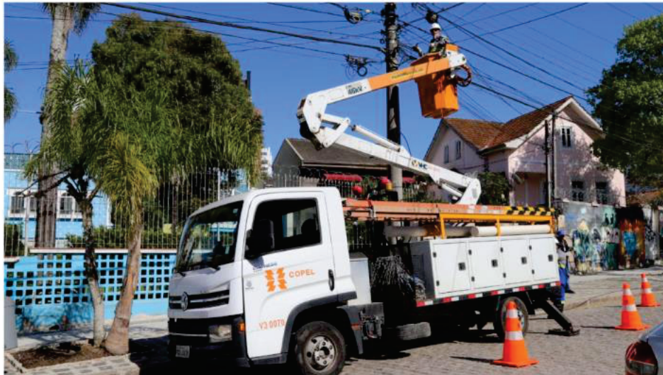
Fios soltos e ociosos costumam estar relacionados a operadoras menores e até mesmo clandestinas que deixam de prestar o serviço, mas não retiram os fios. | Foto: Divulgação/Copel
