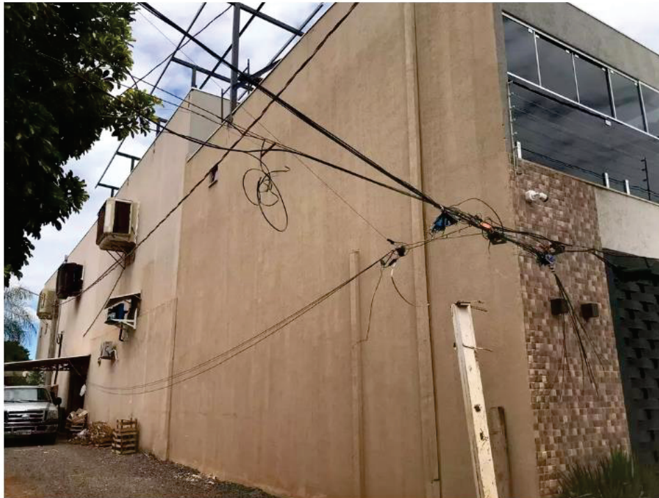
Fiação está solta após troca de postes no cruzamento de ruas no Jardim Centenário. (Foto: Bruna Marques)
